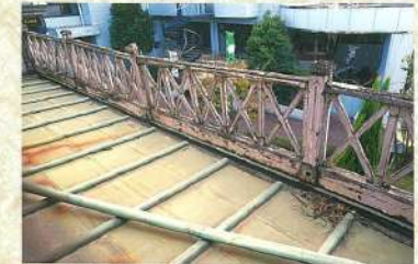
腐朽して崩れそうなベランダの手すり
